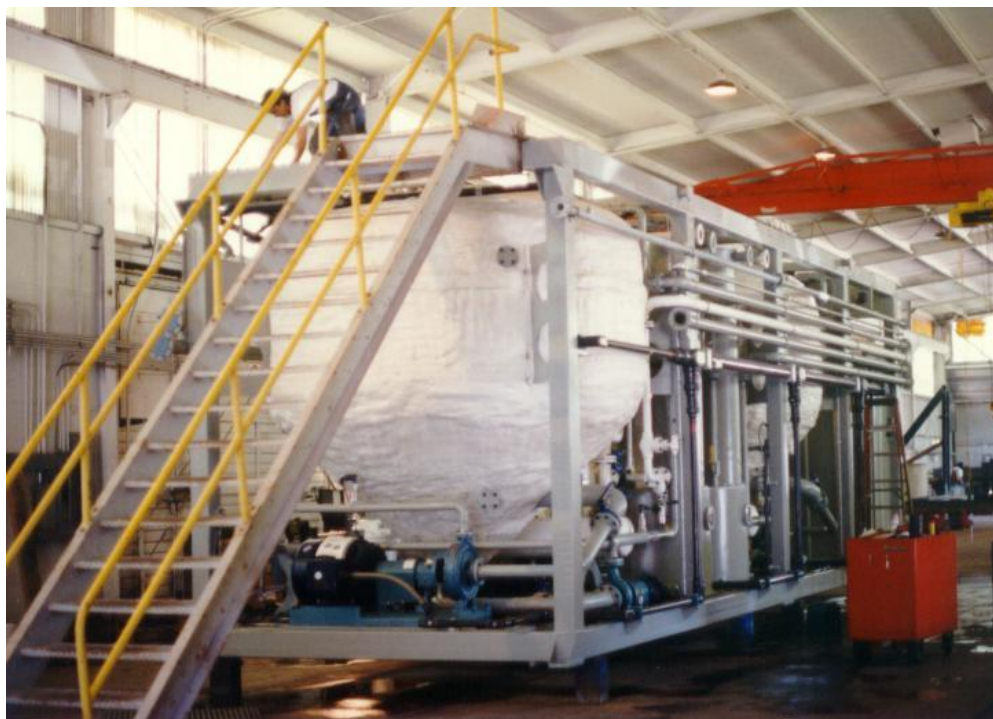
Фото №8. Один из модулей установленный в цеху мойки ж/д цистерн.
