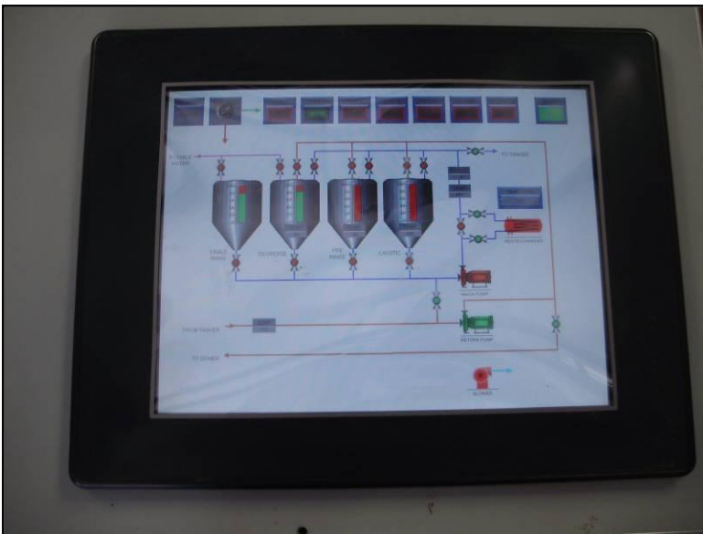
Фото №2 Щит управления и сенсорный экран
