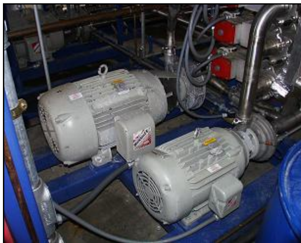
Фото №6 Насосы, установленные на раме
