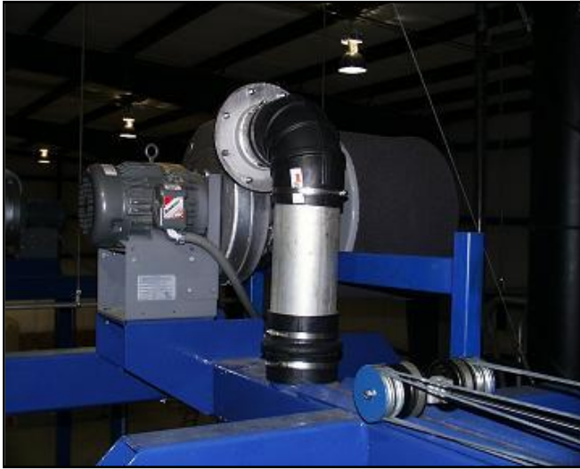
Фото №7 Вытяжной вентилятор
