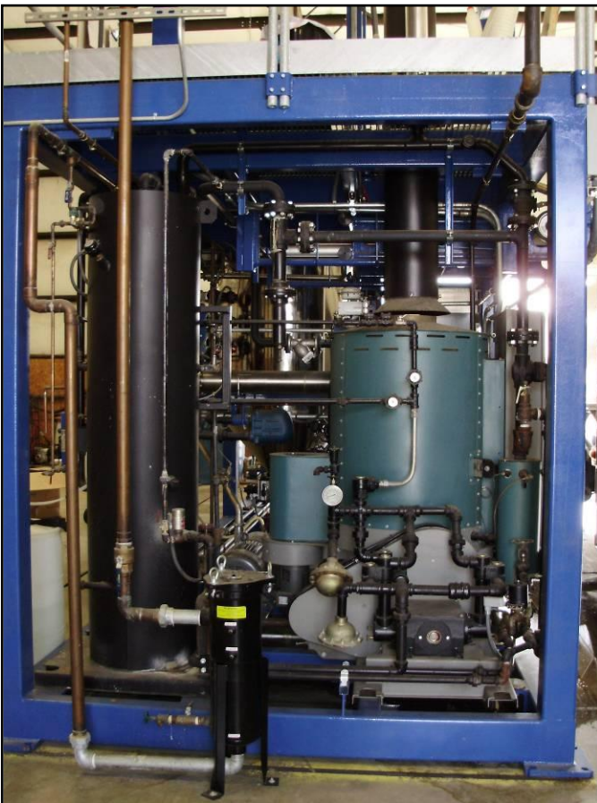
Фото № 6 Система подготовки воды и парогенератор
