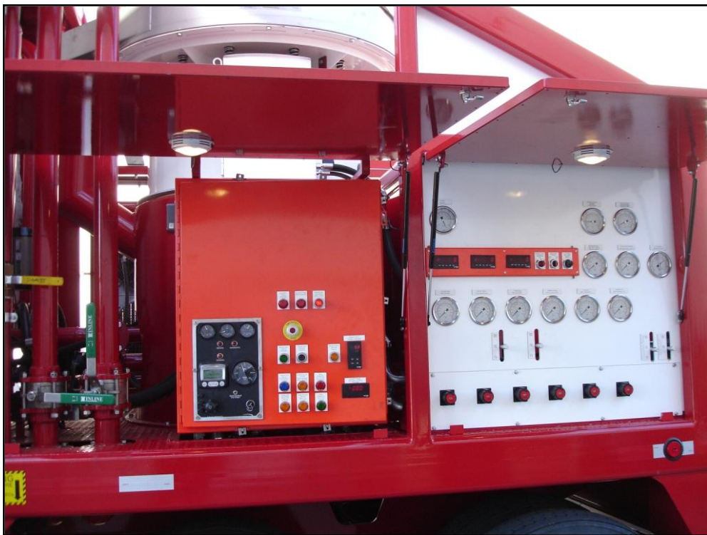
Фото 3. Контрольная панель управления
